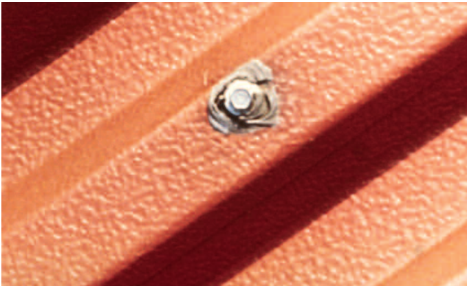
Beschadigd bevestigingsmiddel op dakbekleding.
