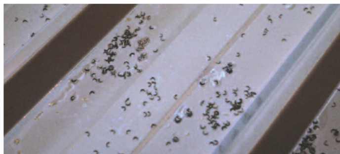
Achtergelaten spanen op een dak
