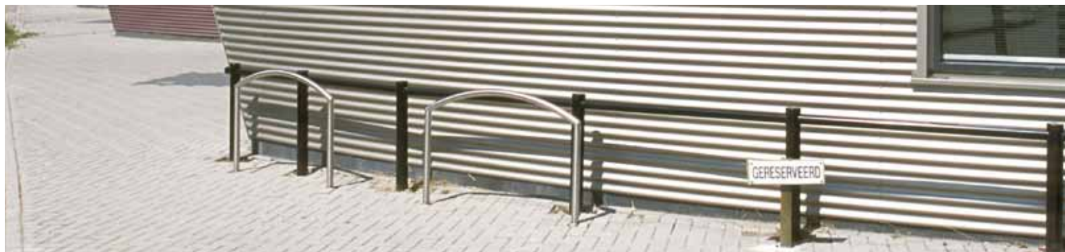
8.9 Afrasteringen en stoepranden beschermen de gevel tegen aanrijdschade.
