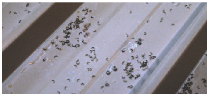
Achtergelaten spanen op een dak
